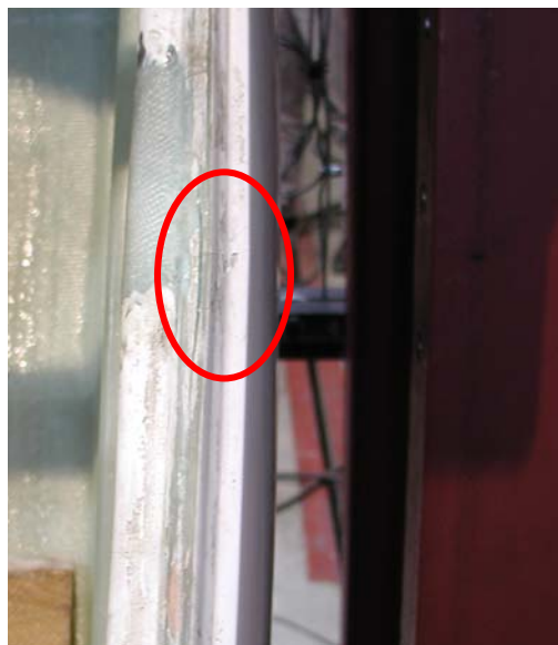
Foto 7. Poškození po ukončení fáze III v místě opravy rámu kabiny.
